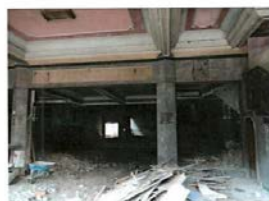
Pavimento térreo com bastante entulho
