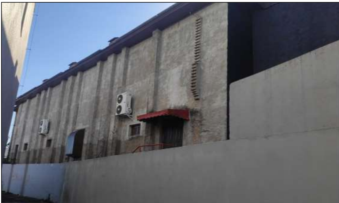
Figura 5: Lateral esquerda do cinema com os pilares de reforço e parte inacabada (05/10/2021).
